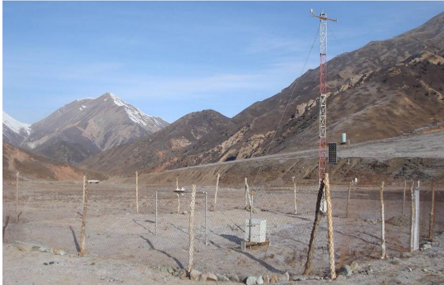
图 e-1 高 10m 的微气象观测塔
